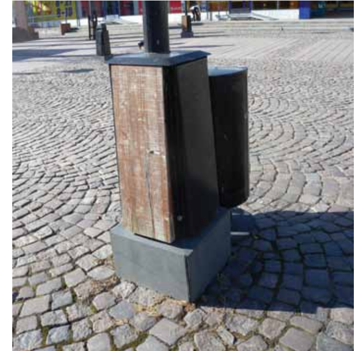
Kuva 36: Valaisinpylväiden kotelot ovat osoittautuneet rakenteeltaan heikoksi.
